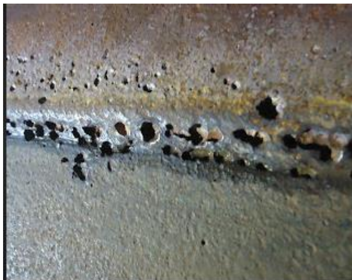
Figura 10: corrosão por pites
