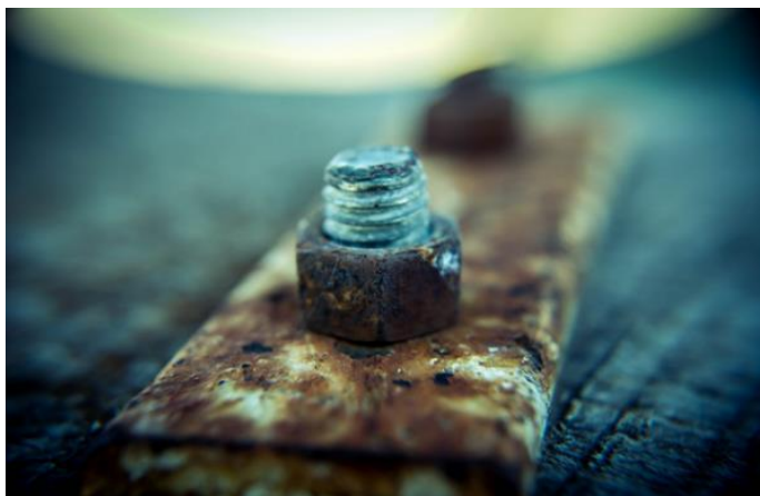
Figura 12: corrosão galvânica ou eletroquímica
